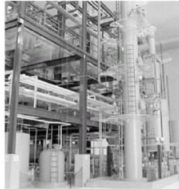
プラスチック油化处理装置
