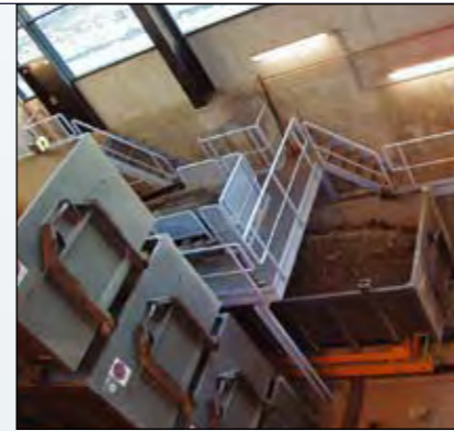
Automatic bottom ash container system at Nordforbrænding.
