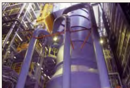
Limestone scrubber, Vestforbrænding
